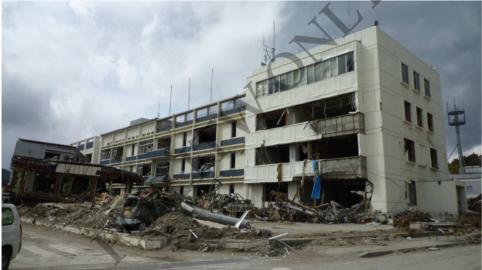
被災した陸前高田市役所（4月4日） 3階天井まで津波は到達
