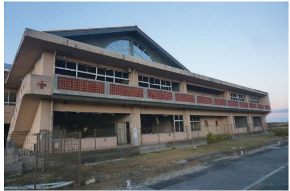
(b)校舍一樓牆壁被海嘯沖毀
