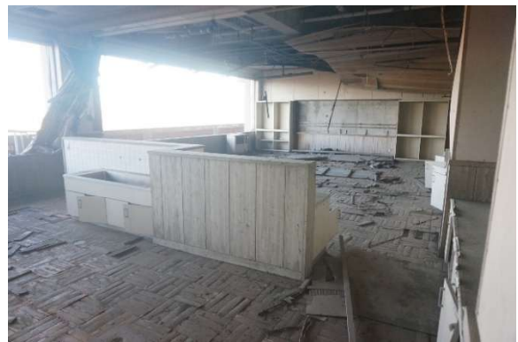
(d)校舍一樓破壞情形
