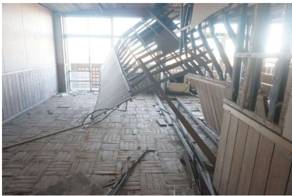
(c)校舍一樓破壞情形
