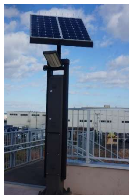
(d)太陽能照明設備
